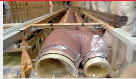
Klimarohre der Firma Kaefer in einer A320.
